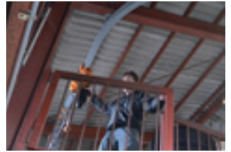
作業効率のアップや預かったエンジンを大切に扱う目的で作成したクレーンは、エンジンの載せ替えや部品取りストックとしても活躍。
